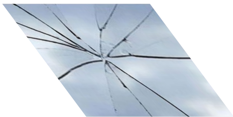
Rotura de un vidrio (sin temprar)
